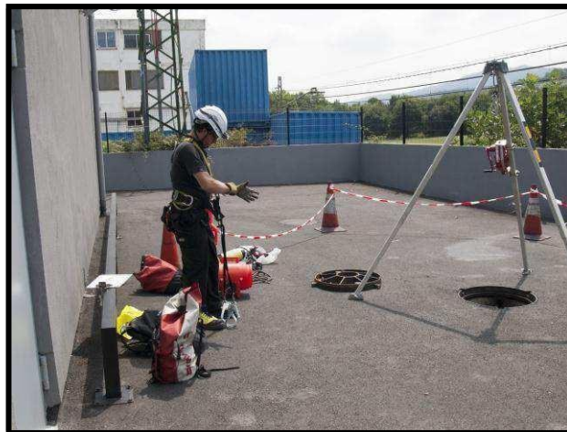
Entrada a un recinto confinado balizado y con el material lejos de la boca de entrada
