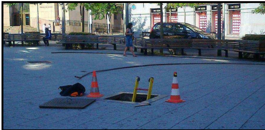
Recinto confinado deficientemente señalizado
